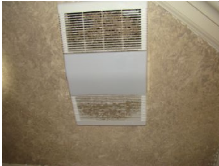
Bathroom Exhaust Fan
